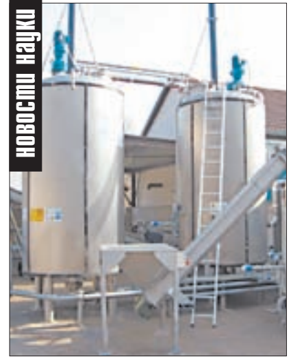
● Станция для получения электричества из растительного мусора в г. Дрезден (Германия).
