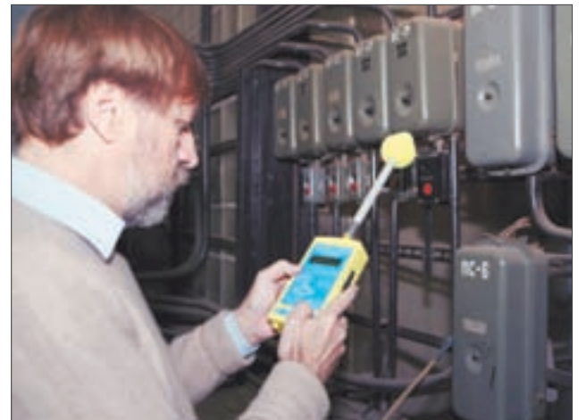
● Измерение электромагнитного поля в щитовой.
